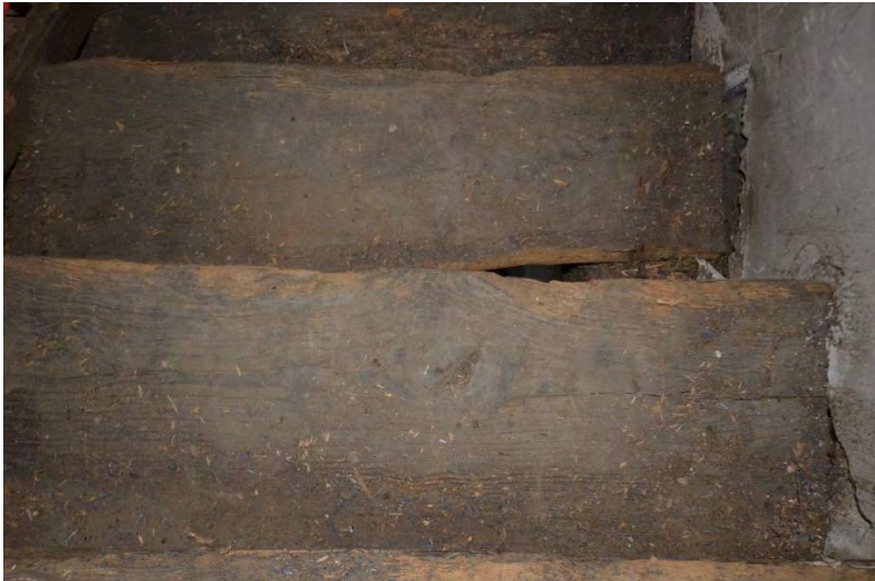
Abbildung T4 Ausgebrochene Trittkanten von oben
