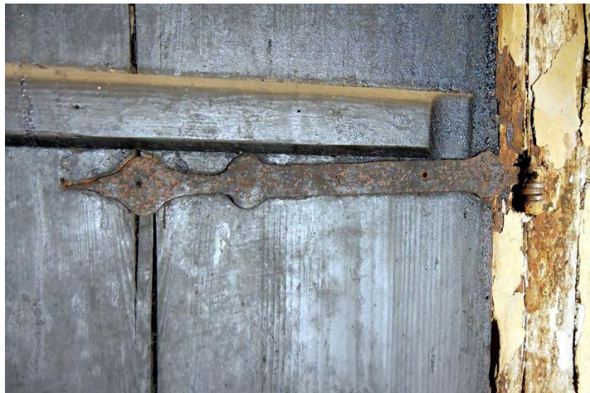
Abbildung T4 Langband der Tür in der Küche T1.03 Verrußte und verkrustete Oberfläche
