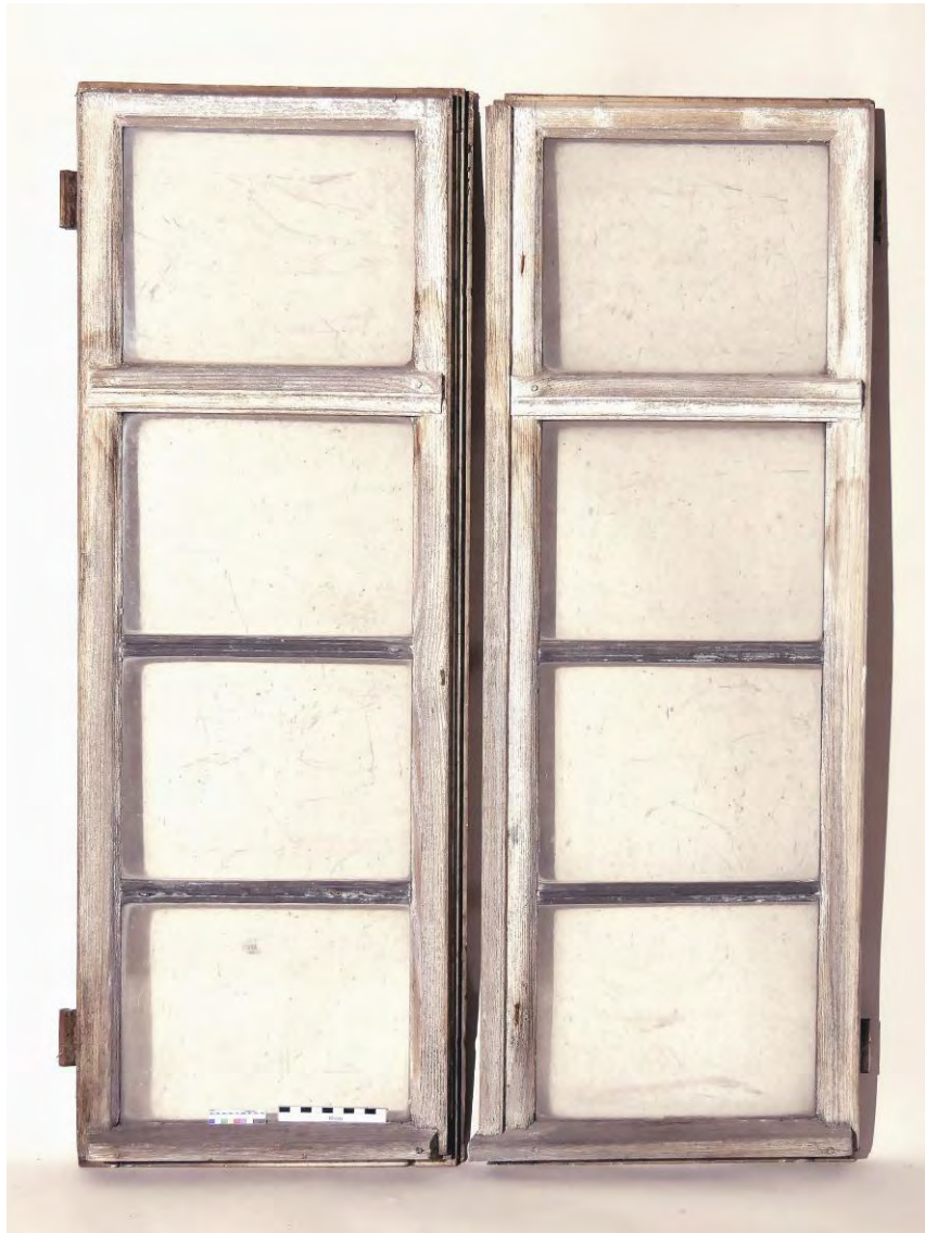
Abbildung F6 Fenster F1.13 im Raum 1.05 Außenflächen der Flügel Vorlage für die Rekonstruktion des Fensters links daneben (Bedarfsposition) siehe auch Konstruktionszeichnung
