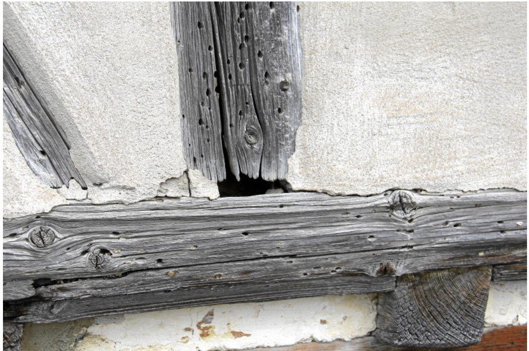
Abb. 02: Schadhafter Ständeranschluss an Schwelle.
