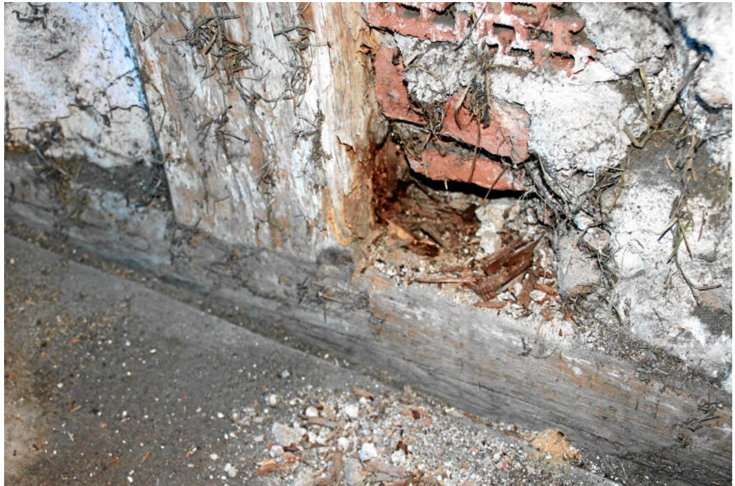
Abb. 10: Pilz- und Insektenschädigung an Schwelle und Fensterständer unterhalb der Brüstung.
