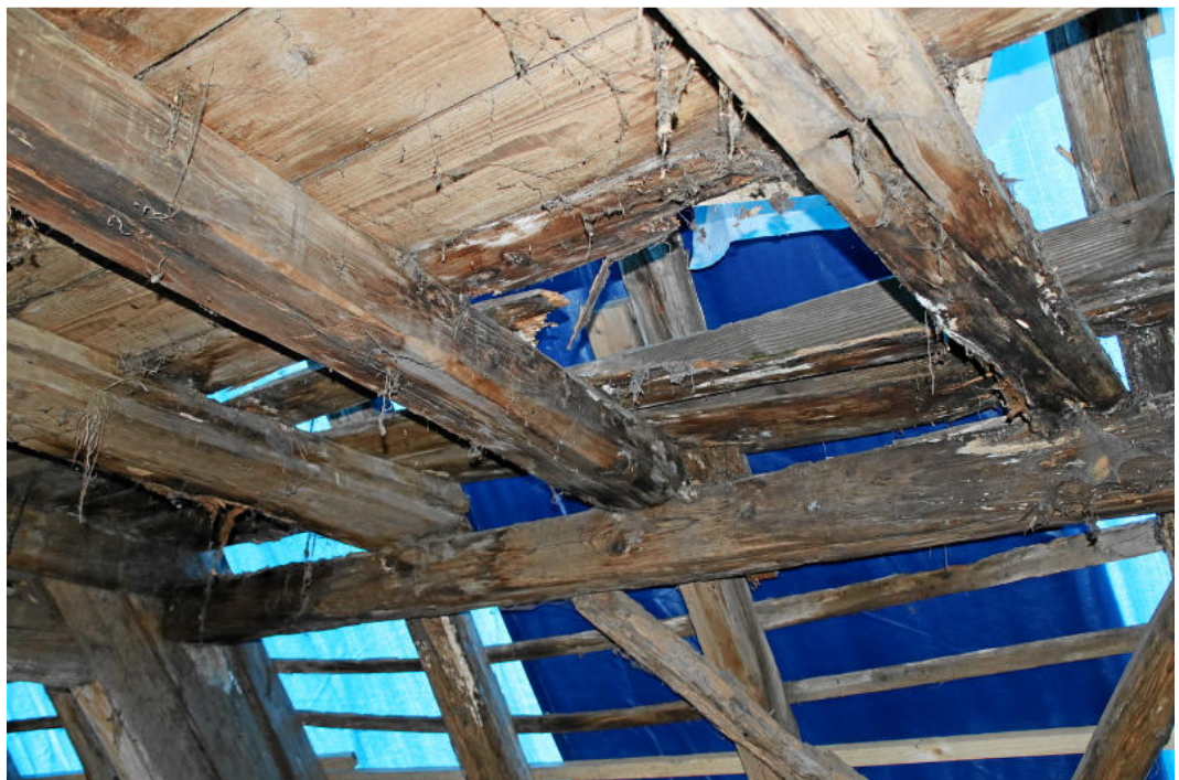
Abb. 31: Pilzschäden an Kehlbalken, Stuhlrähm, Sparren und Fünfkantstuhlschwelle.
