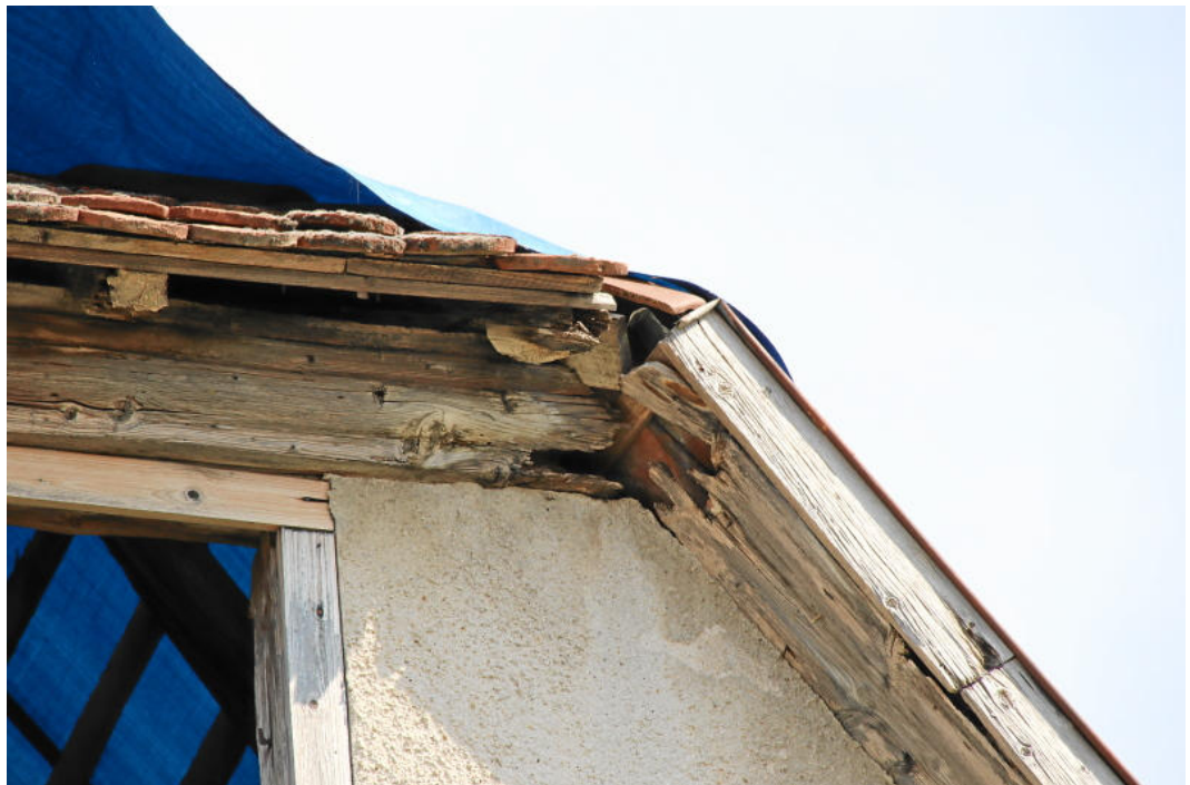
Abb. 11: Schadhafte profiliertes Wandrähm am Krüppelwalm.
