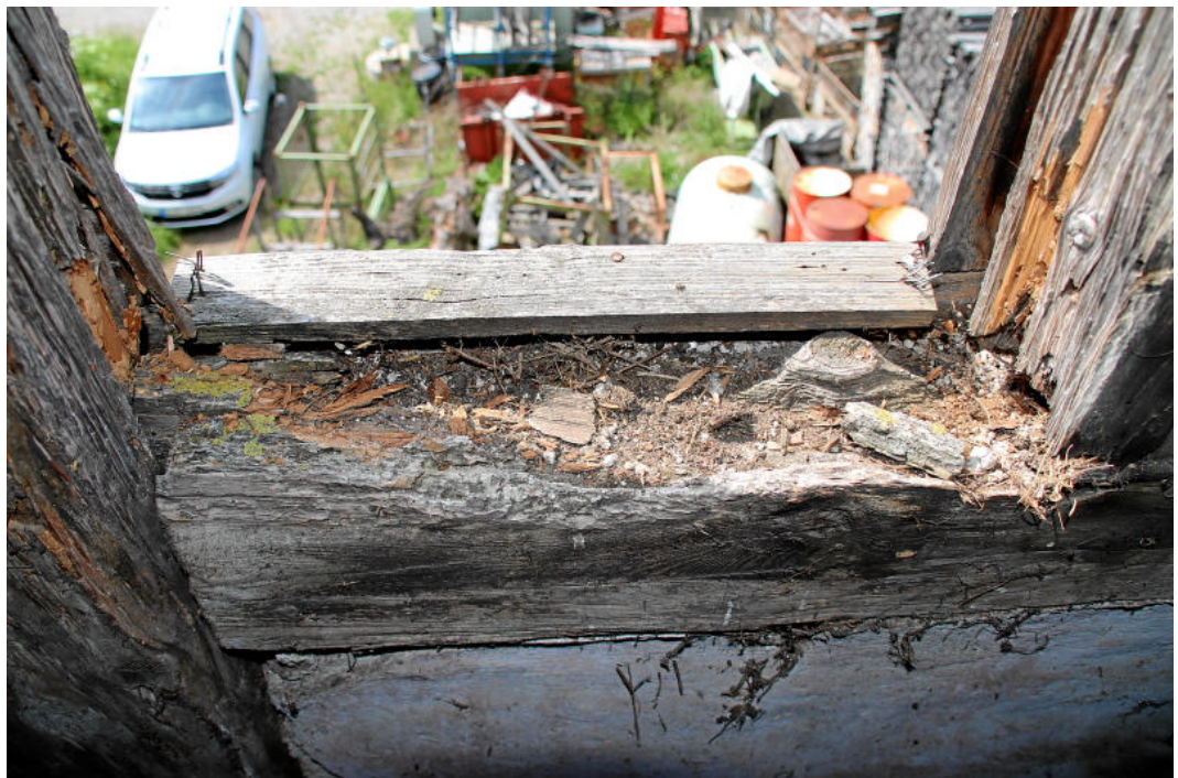
Abb. 09: Holzschäden an der Fensterbrüstung.
