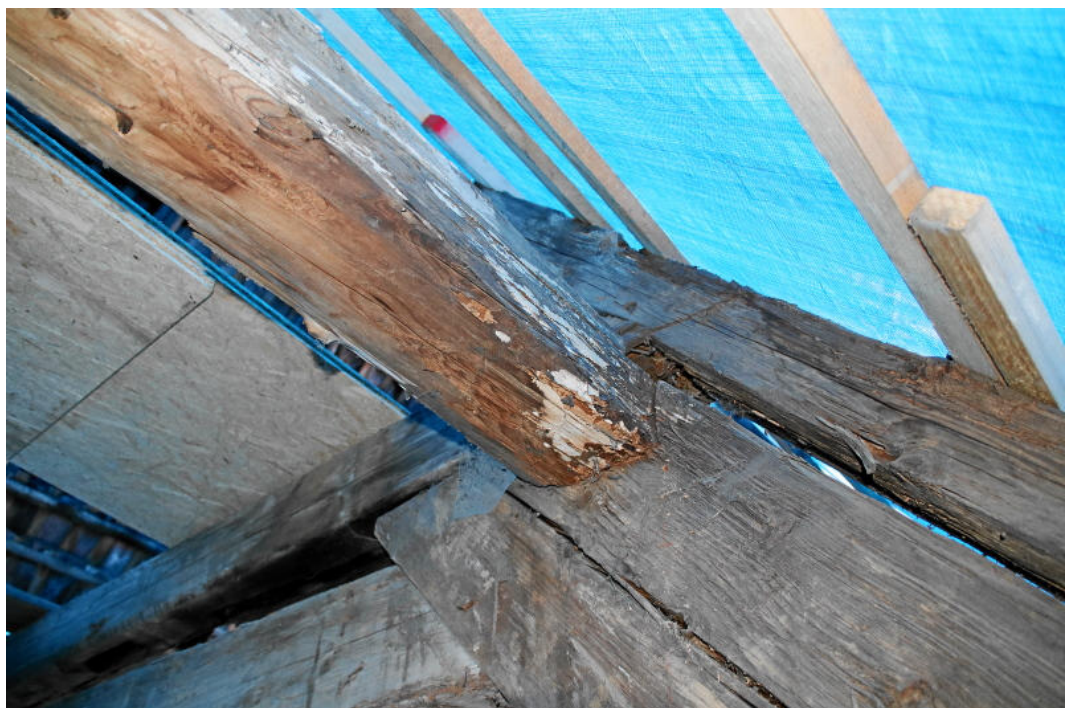
Abb. 33: Holzabbau durch Pilze an Stuhlrahm, Kehlbalcken, Sparren und Stuhlstrebe.
