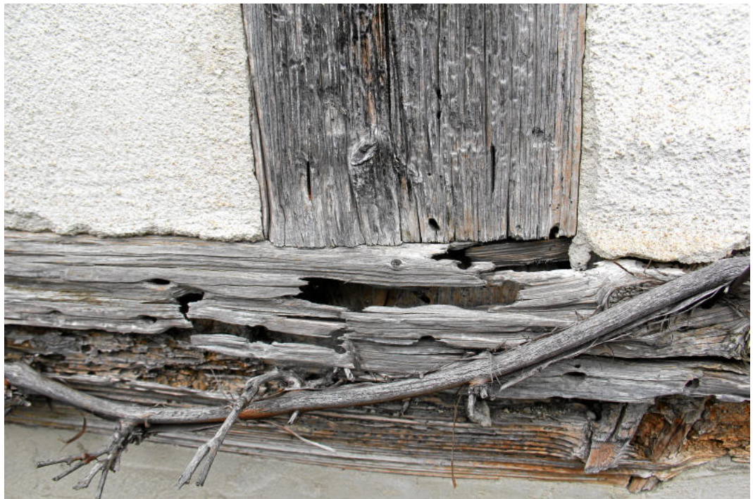
Abb. 06: Pilz- und Insektengeschädigte Schwelle.
