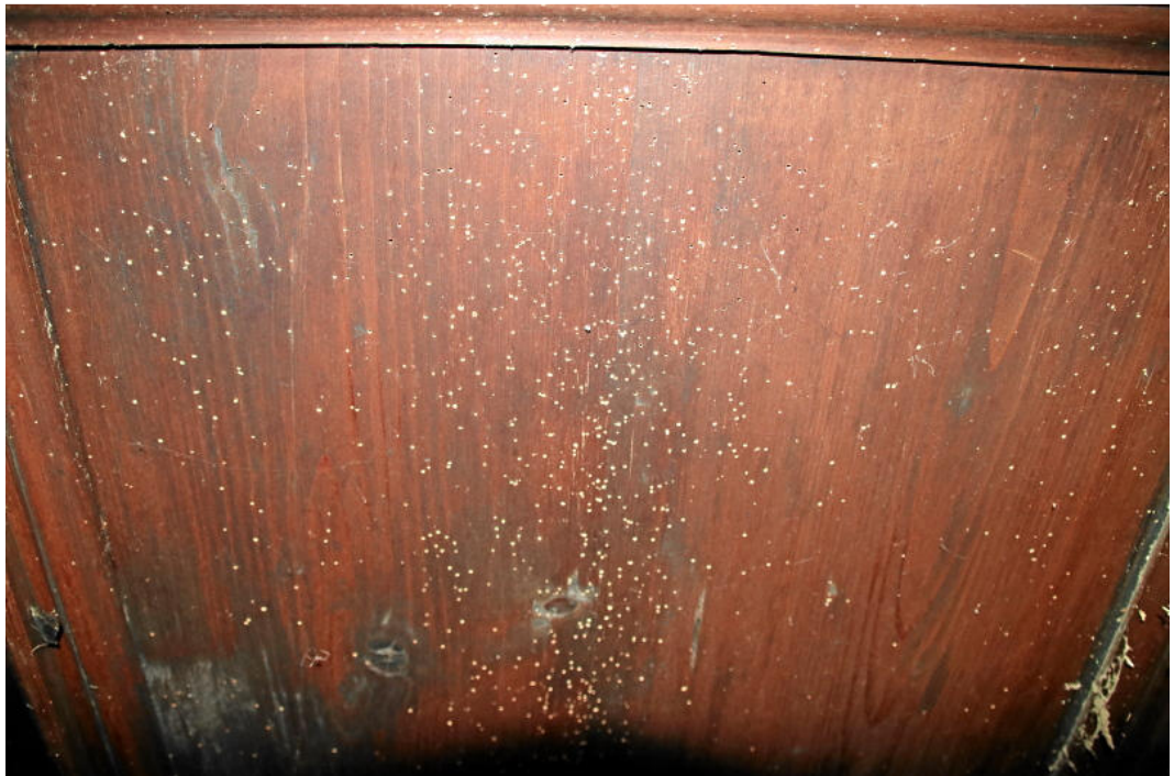
Abb. 26: Nagekäferbefall an Decke.
