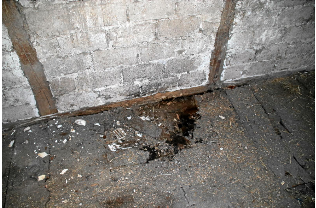
Abb. 21: Schadhafter hölzerner Bodenaufbau.
