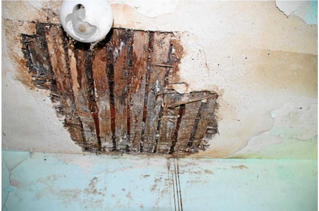
Abb. 23: Schadbereich an der Decke.
