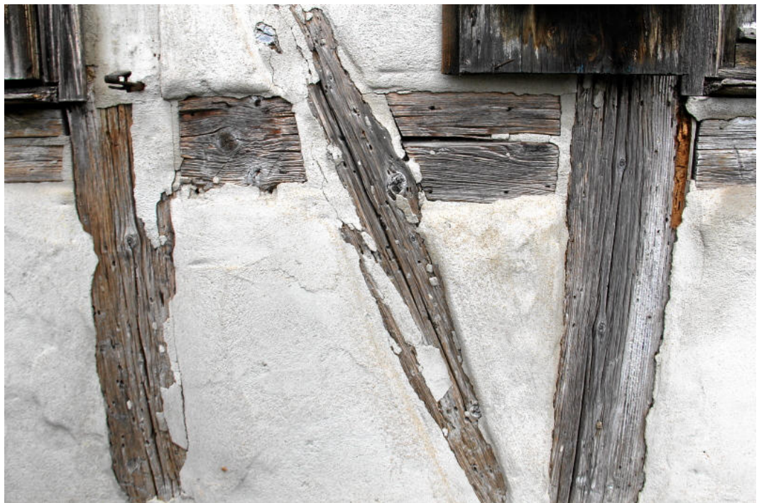
Abb. 05: Risse und Ablösungen am Oberputz des über das Fachwerkholz geführten Gefacheputzes.
