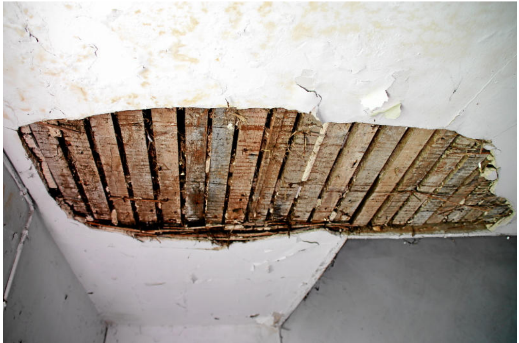
Abb. 16: Herabgefallener Deckenputz und bräunliche Wasserflecken.
