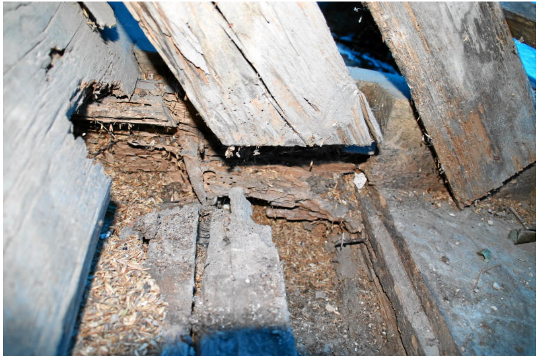
Abb. 28: Durch Braunfäulepilze, Gewöhnlichen Nagekäfer und Holzameisen geschädigter Auflagerbereich.
