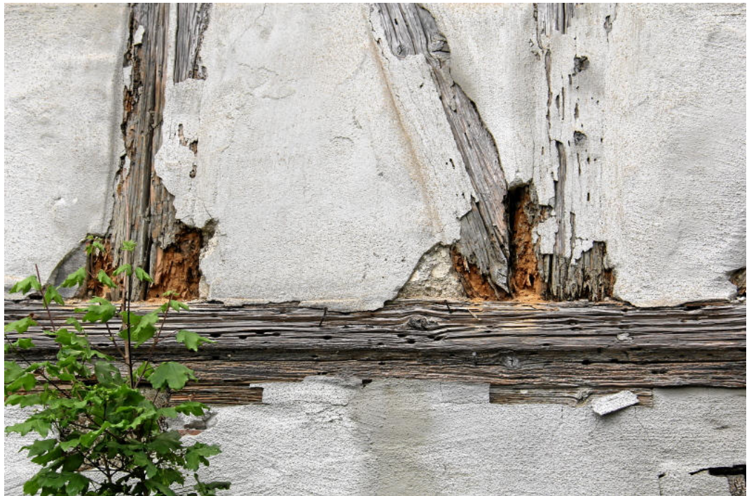
Abb. 03: Umfangreiche Hausbockfraßschäden an Strebe und Ständern.
