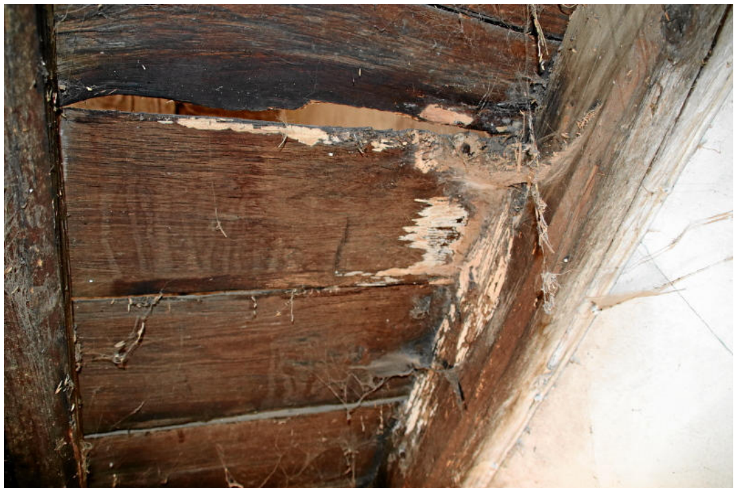
Abb. 20: Pilzgeschädigte Treppe zum DG.
