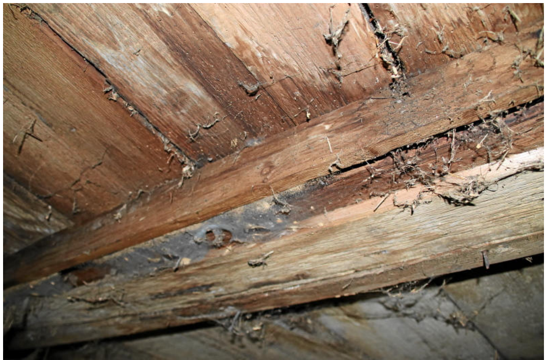
Abb. 35: Aktiver Nagekäferbefall an Dachbalken und Bretterboden.
