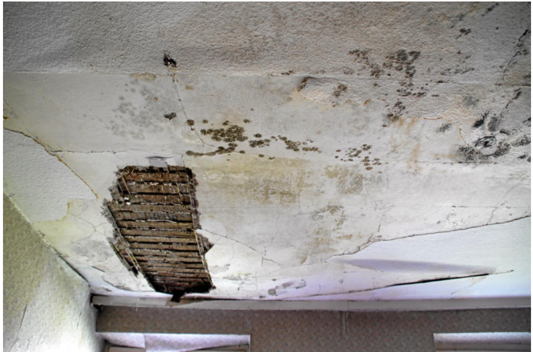
Abb. 18: Feuchteflecken und herabgefallener Deckenputz.
