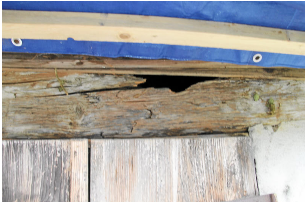
Abb. 15: Schadhafte Wandrähm unterhalb der Dachbalkenlage.
