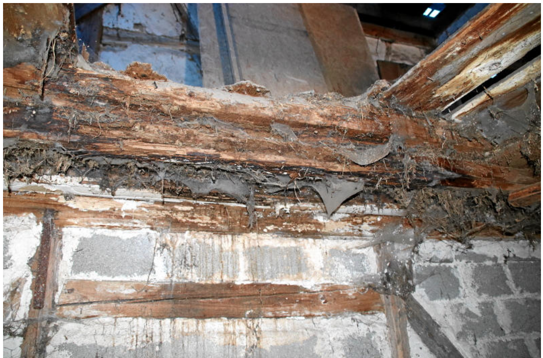
Abb. 22: Schadhaftes Fachwerk bzw. doppeltes Hängesprengwerk.
