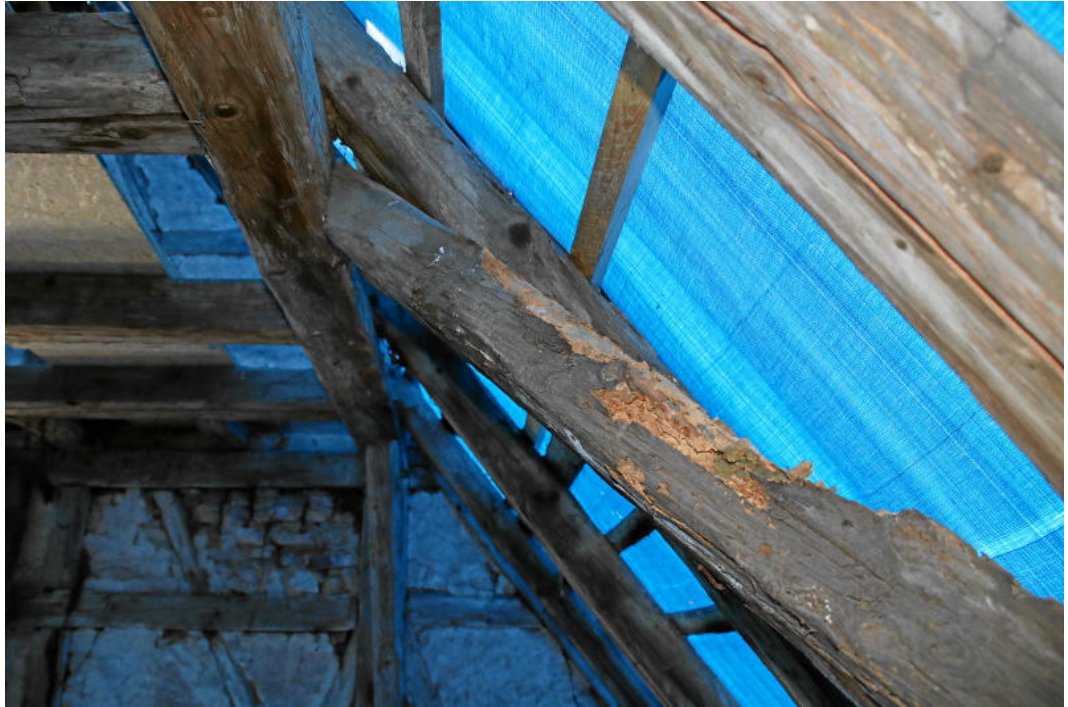
Abb. 36: Hausbockfraßschäden an einer Längsverbandsstrebe.
